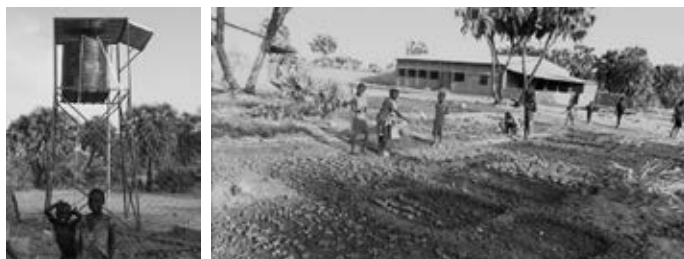
Solarpumpe und Wasserhochbehälter
